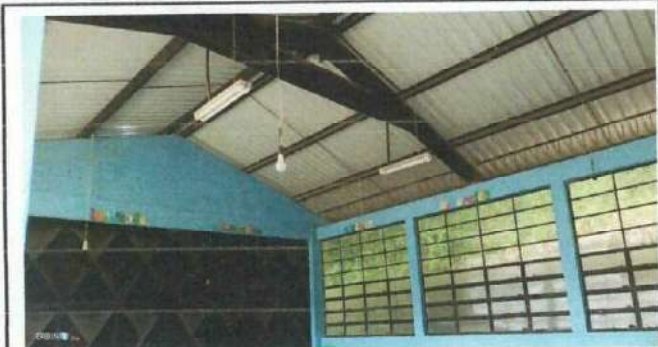
Foto1: Aula 5 modulo 2. No cuenta con buena iluminación eléctrica, lo cual es necesario restructurar, para la época de invierno.
