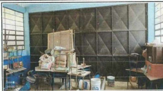
Foto 2: aulas 4 y 5 Modulo 2, las puertas internas ya muestran desgaste y oxido, por lo cual deben ser restauradas.
