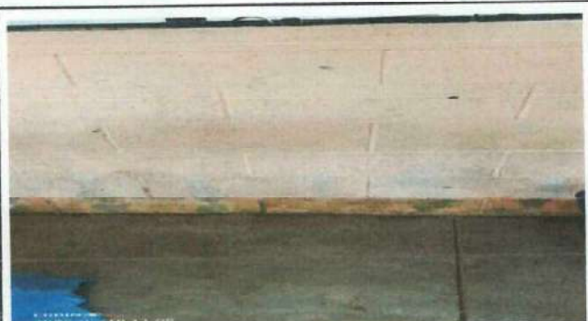
Foto 3: Aula 6 y 7 Modulo 2. La pintura se encuentra en mal estado por el ingreso de humedad y uso de las mismas.
