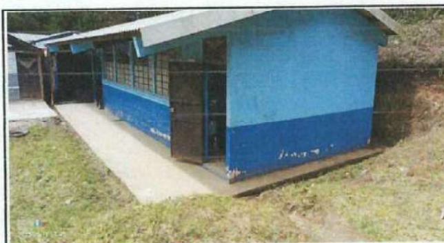
Foto 4: Modulo 2. La pintura se encuentra muy malgastada. Por el clima y el uso que se le da al edificio escolar.
