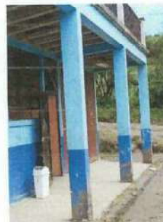
Foto 2: Modulo 3. Se observa el desgaste de la pintura exterior del modulo, lo cual esta en mal estado y sucio.
