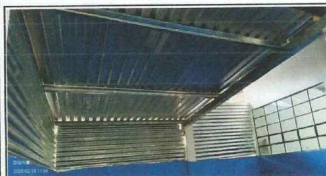
Foto 3: Pasillo modulo 1. Se observa que se necesita mayor lumionicidad de los pasillos, por lo cual se debe restructurar el sistema electrico, y mejorar la iluminación para la epoca de invierno.
