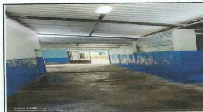
Foto 4: pasillo modulo 1. No cuenta con suficiente iliminación, por lo cual se debe restructurar y mejorar para la epoca de invierno.
