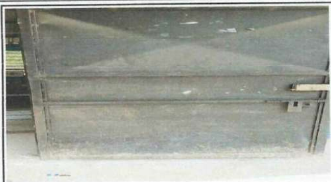
Foto 1: Las puertas de las aulas de los diferentes modulos, ya presentan desgaste y oxido por el clima y el uso de las mismas.
